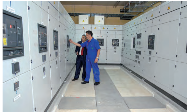
Profesionales del hospital trabajando en el nuevo centro de transformación
